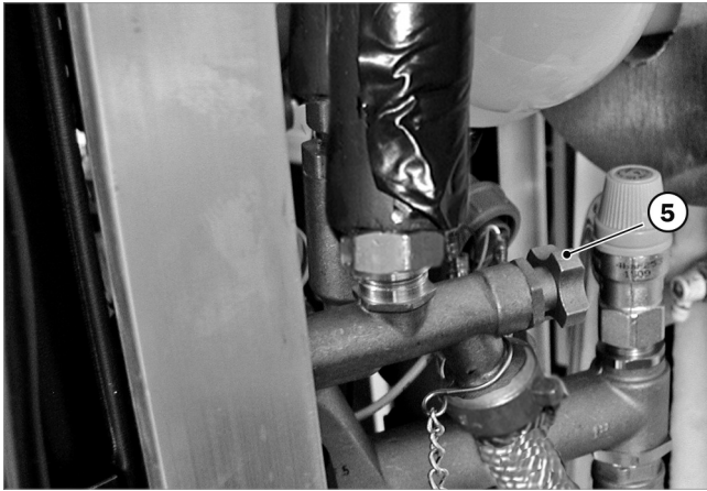
Abb. 57: Spülhahn am Solar-Vorlauf
