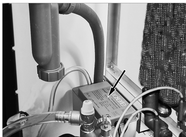
Abb. 38: Einbauort der Kondensathebepumpe
