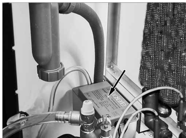
Abb. 38: Einbauort der Kondensathebepumpe
