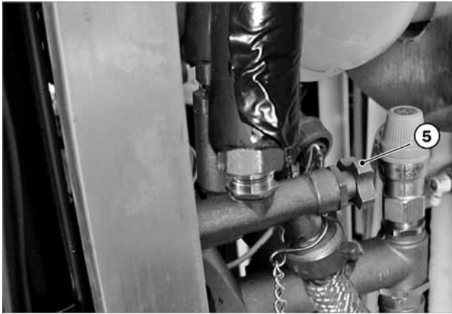
Abb. 57: Spülhahn am Solar-Vorlauf
