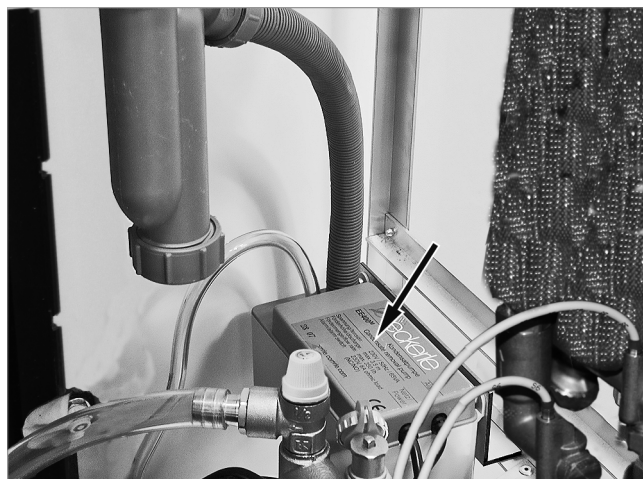
Abb. 40: Einbauort der Kondensathebepumpe
