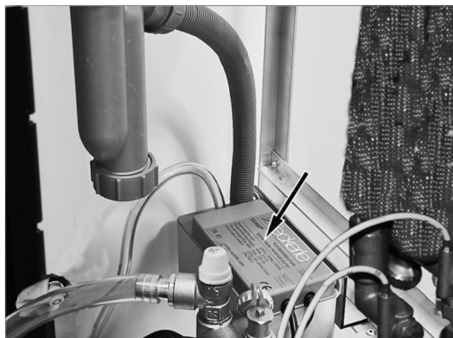
Abb. 40: Einbauort der Kondensathebepumpe
