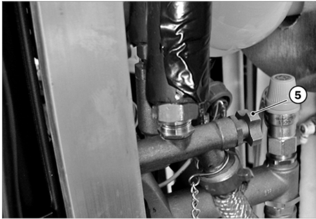
Abb. 61: Spülhahn am Solar-Vorlauf
