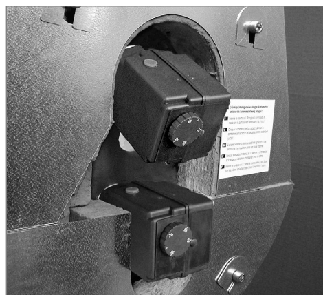
Résistances électriques chauffantes et isolation de la bride installées
