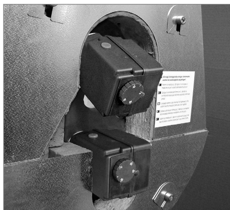
Riscaldatori elettrici ad immersione e isolamento flangia montati
