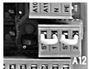
ST1/ST2 con 2 ponticelli
