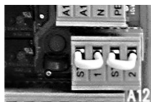
ST1/ST2 avec 2 ponts
