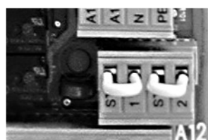
ST1/ST2 con 2 ponticelli
