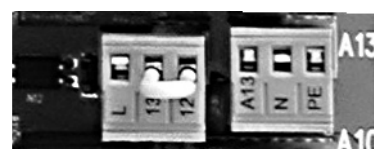
L/13/12 mit Brücke auf 12 - 13
