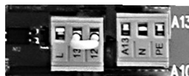
L/13/12 con ponticello su 12 - 13
