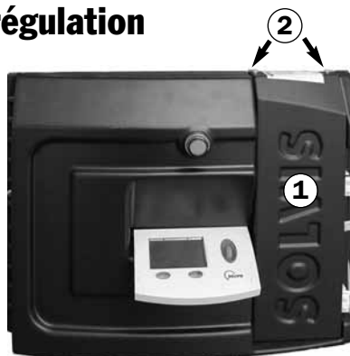
Ancienne console de régulation
