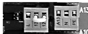
L/13/12 mit Brücke auf 12 - 13
