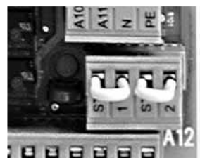
ST1/ST2 avec 2 ponts
