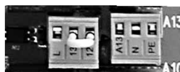
L/13/12 con ponticello su 12 - 13
