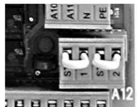
ST1/ST2 con 2 ponticelli
