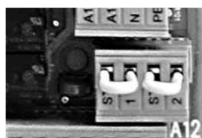
ST1/ST2 avec 2 ponts
