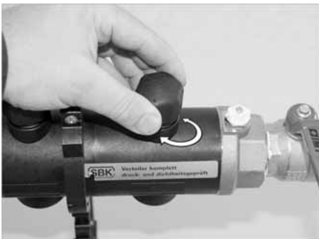
Abb. 9: Ventile am Soleverteiler
