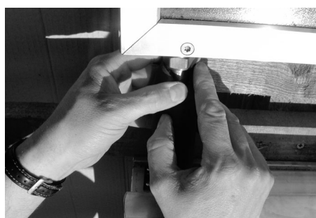
Kollektorverbinder KV-F-Ü am unteren Kollektor verschraubt
