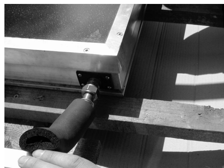
Kollektorverbinder KV-F-Ü am unteren Kollektor verschraubt
