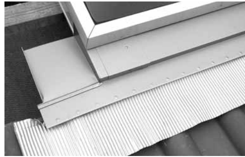
Linke Bleischürze (mit Ecke) eingelegt
