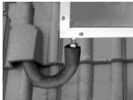
flexibler Anschluss für Solarvor- und rücklauf
