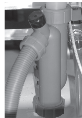
Siphon mit Kondensatschlauch
