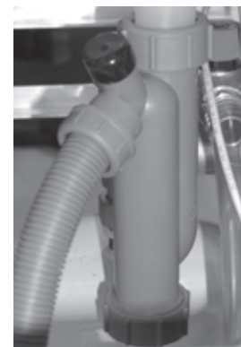
Siphon mit Kondensatschlauch
