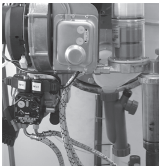
Ölleitung von Pumpe zu Filter
