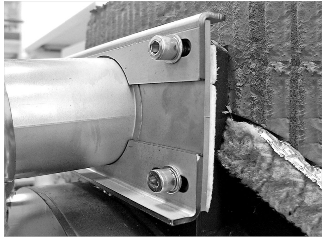
Fig. 4: Refuerzo de la brida de conexión de la salida de humos
