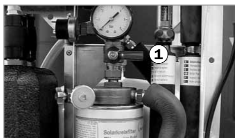
Llave de bola sobre el filtro solar cerrada
