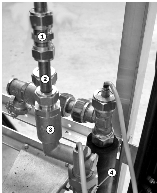
Abb. 12: Anschlusswinkel mit Schwerkraftbremse eingebaut
