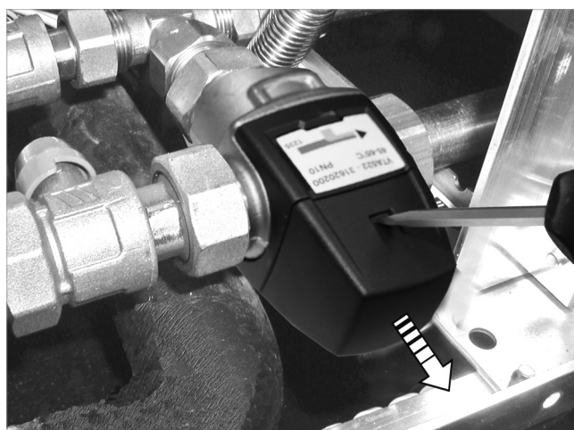
Fig. 6: Rimozione del coperchio della valvola TMV
