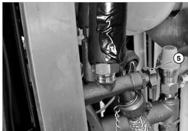
Abb. 65: Spülhahn am Solar-Vorlauf
