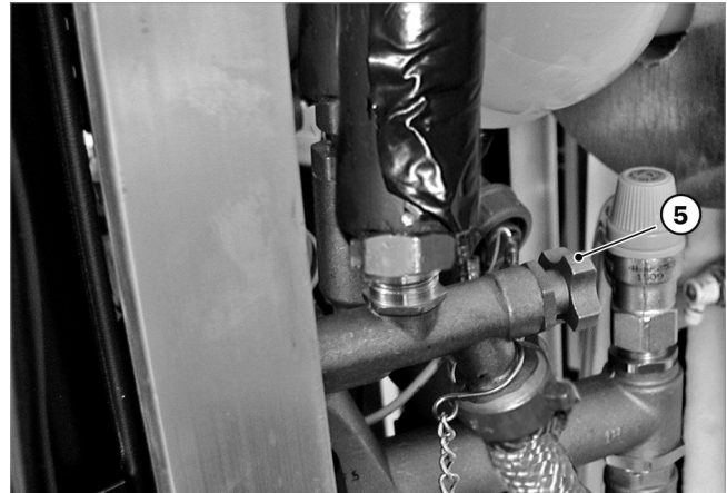
Abb. 88: Spülhahn am Solar-Vorlauf
