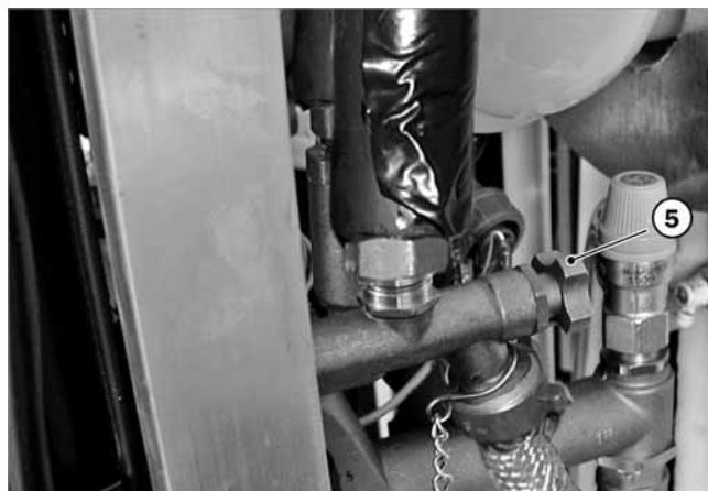
Abb. 88: Spülhahn am Solar-Vorlauf
