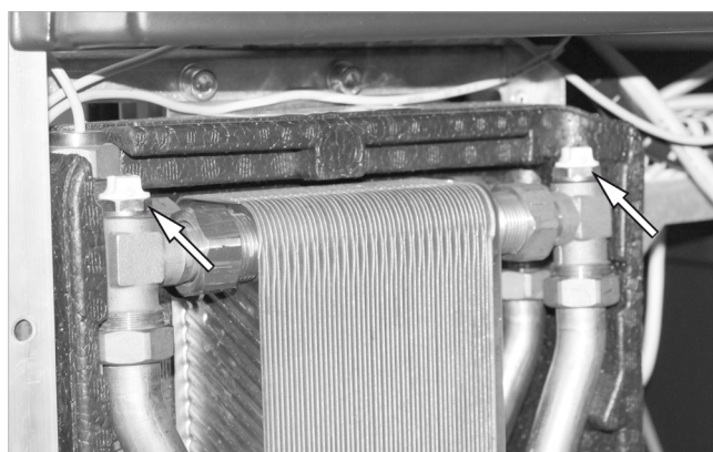
Abb. 6: Zuleitungen entlüften (hier abgebildet SolvisMax 06)
