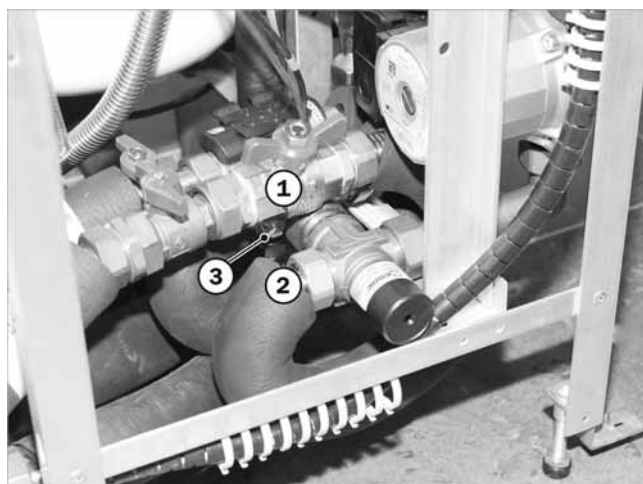
Abb. 4: Fühleraufnahme am Vorlauf montiert
