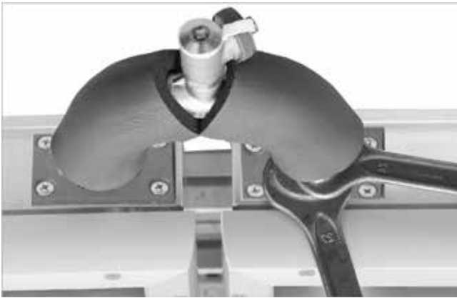
Abb. 64: Verbindung Kollektoren nebeneinander
