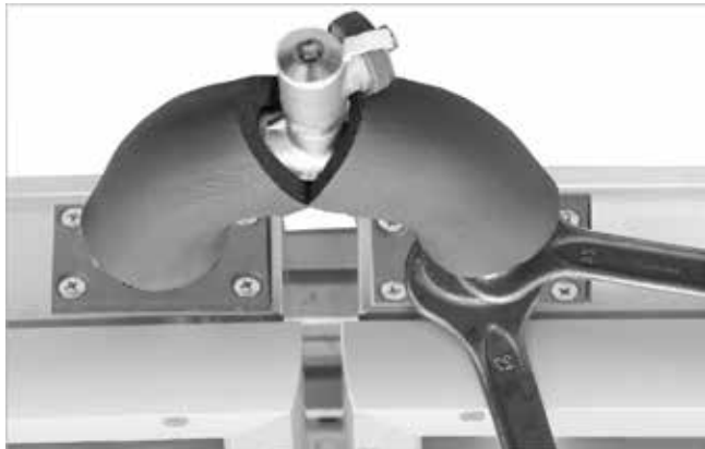
Abb. 67: Verbindung Kollektoren nebeneinander
