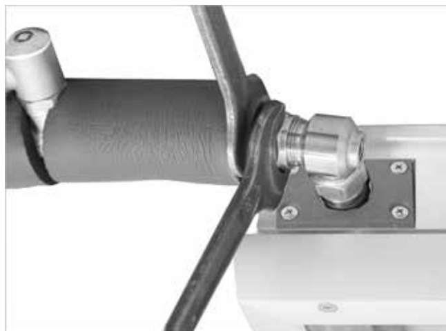
Abb. 57: Anschluss oben: Solar-Vorlauf
