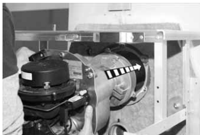
Fig. 7: Instalación del quemador
