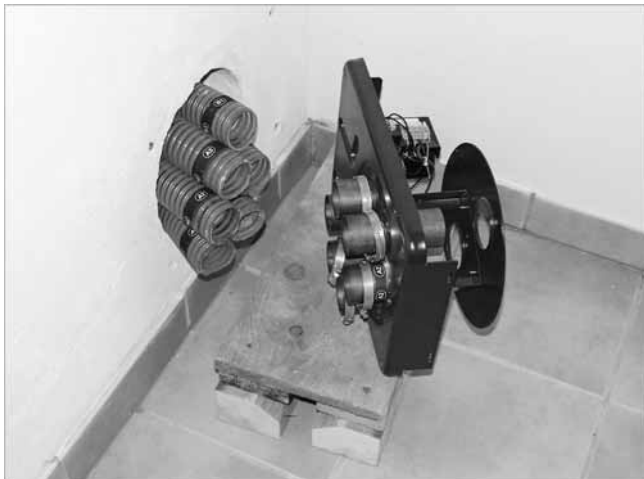
Abb. 15: Umschalteinheit mit Schlauchenden
