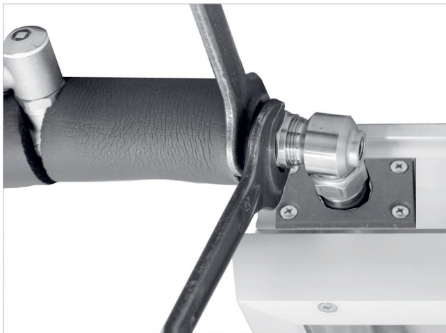
Abb. 57: Anschluss oben: Solar-Vorlauf
