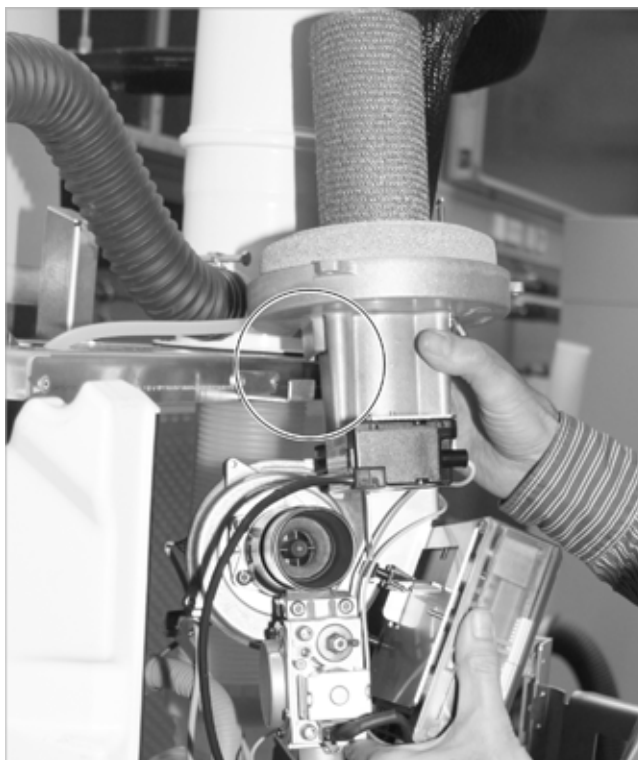
Fig. 31: Quemador en posición de mantenimiento en la consola
