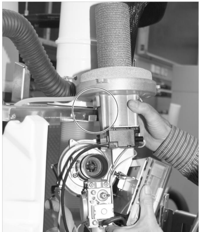
Fig. 31 : brûleur en position de maintenance sur la console
