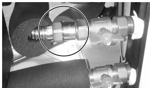
Abb. 5: Wellrohre am Rücklauf eingesetzt
