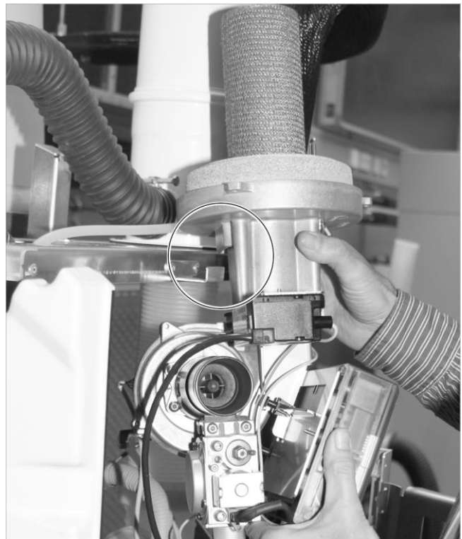
Afb. 31: Brander in onderhoudspositie aan de console
