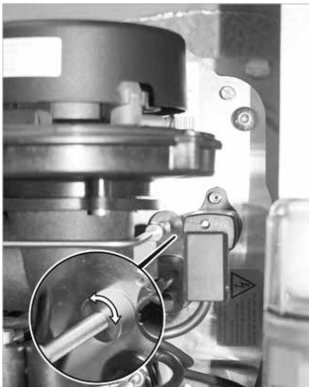
Abb. 151: Rändelmutter (Anschluss Ölleitung / Düsenstock)
