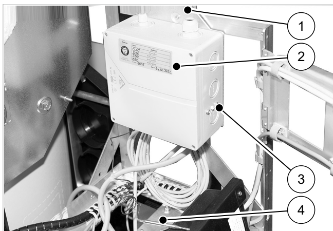
Abb. 18: Anschlussbox für Heizpatrone, montiert
