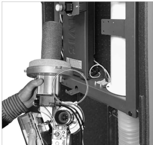
Afb. 141: Brander aan de console hangen (onderhoudspositie)
