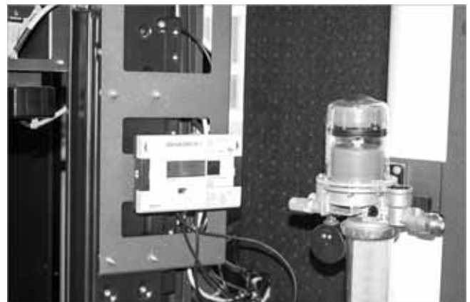
Abb. 13: Rechenwerk hinter Netzbaugruppe
