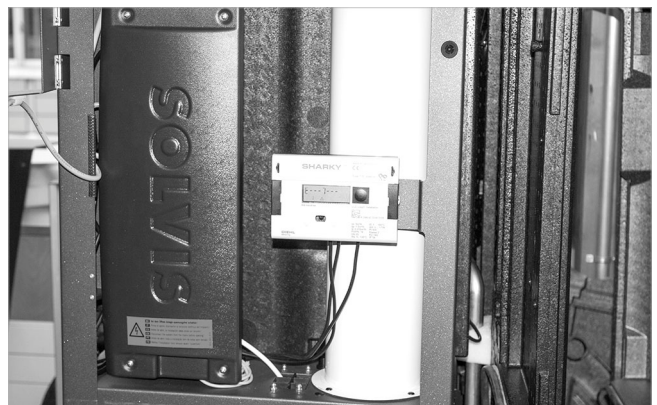
Abb. 14: Nur SolvisBen Gas: Rechenwerk an Halterung für Ölfilter
