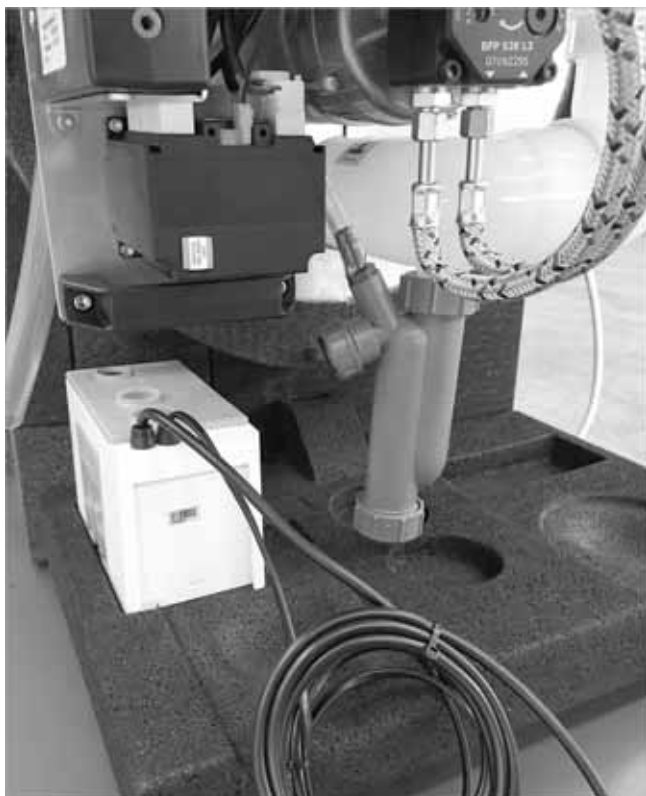
Fig. 2 : installation dans SolvisBen
