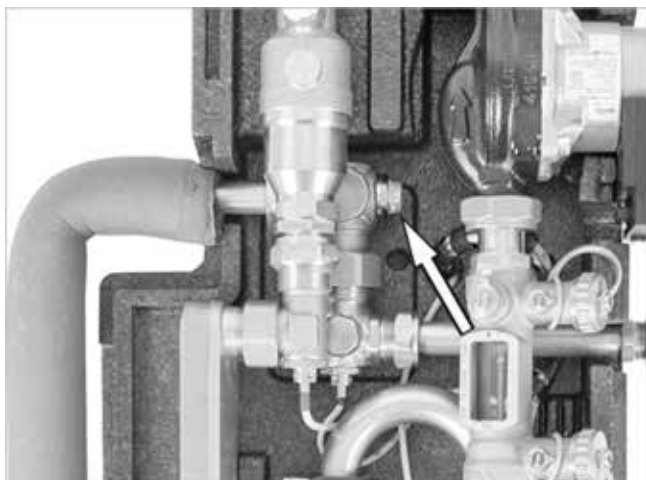
Fig. 17 : dispositif de purge manuel côté secondaire
