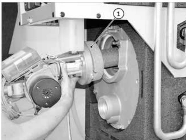
Fig. 49 : Montage du brûleur
