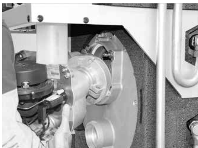
Fig. 70 : montage du brûleur
