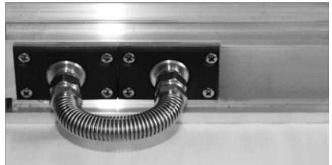
Fig. 45: curva di raccordo montata
