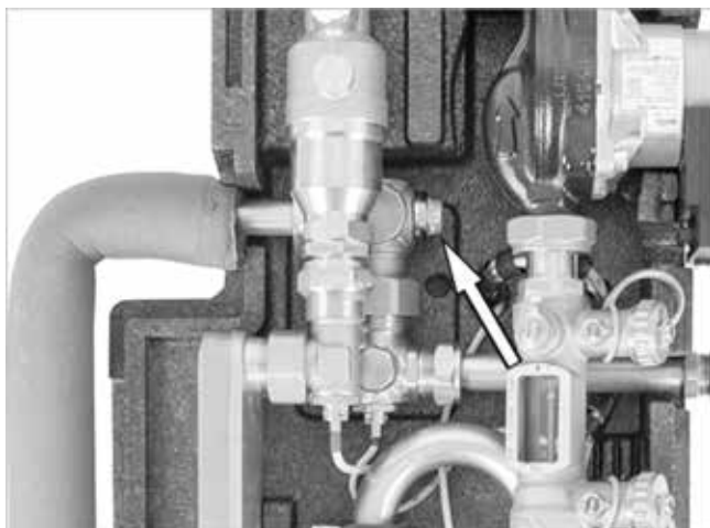
Fig. 17: Purgador de aire manual del lado secundario
