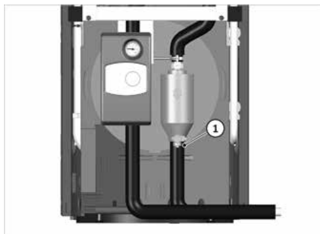
Fig. 82: pulizia del separatore di fanghi tramite rubinetto di scarico
