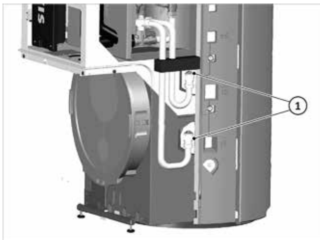
Fig. 30 : contrôler / resserrer les raccords de la station de chauffage
