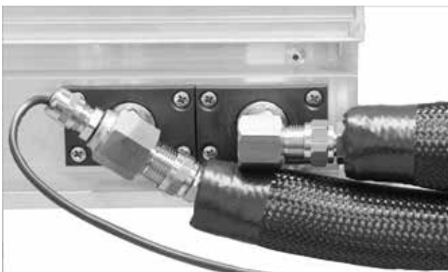
Fig. 44: Conexión flexible con aislamiento
