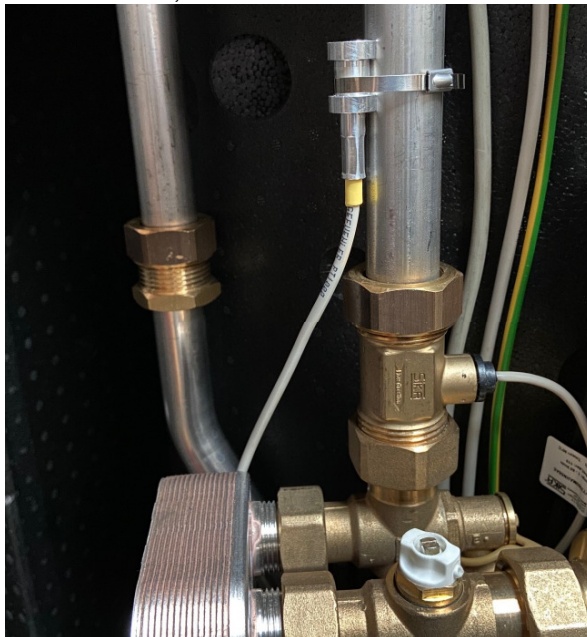
hier: Montage Anlegefühler im SolvisBen
