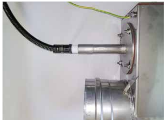
Abb. 5: Hochspannungskabel am Isolator montiert
