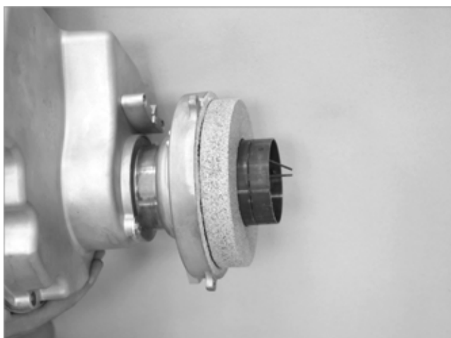
Fig. 53: applicazione del portello caldaia con isolante refrattario
