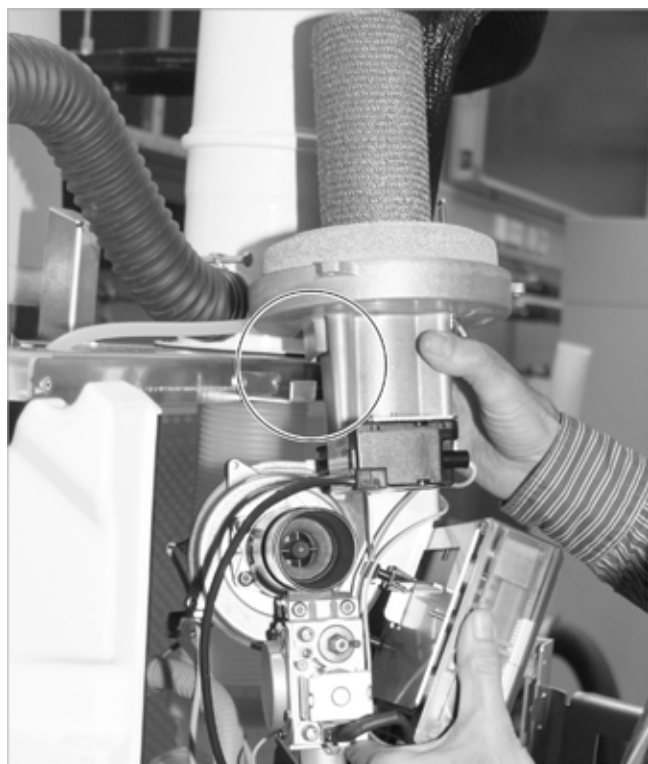
Fig. 109: bruciatore in posizione di manutenzione sulla console
