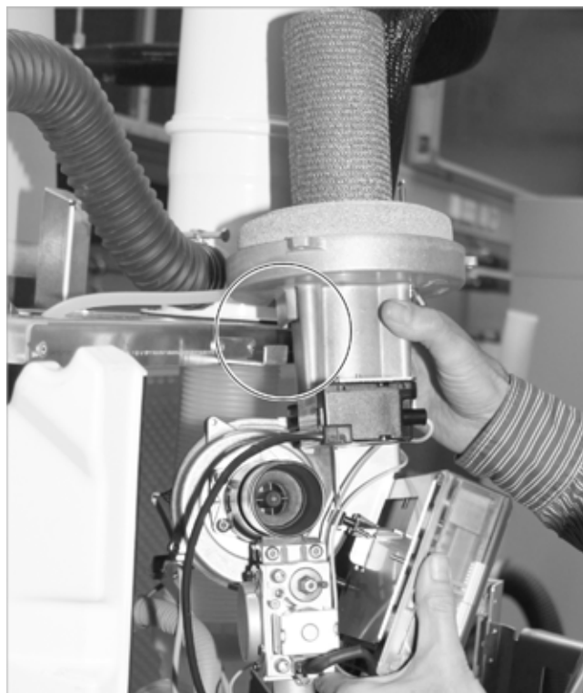
Fig. 109: Quemador en posición de mantenimiento en la consola
