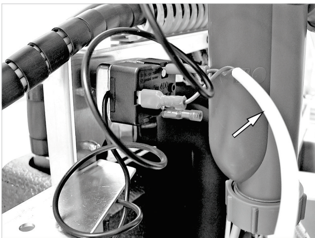
Fig. 70: mSTB et câble de raccordement
