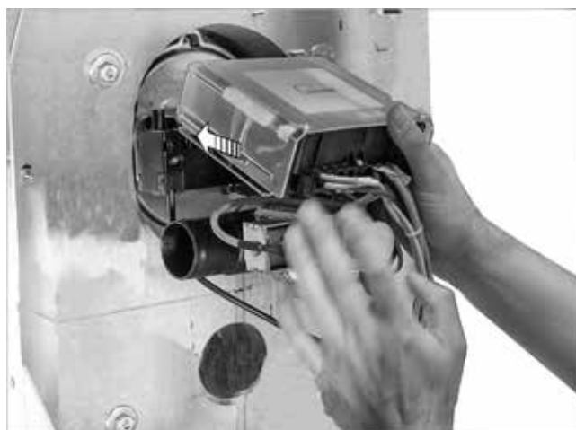
Fig. 28 : montage du brûleur
