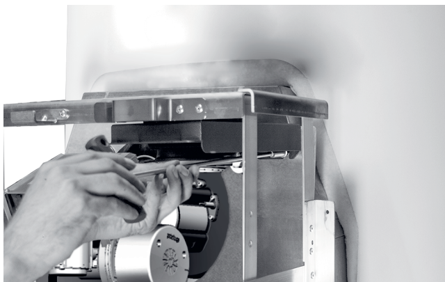
Fig. 38: Serraggio del supporto della tenuta a soffietto
