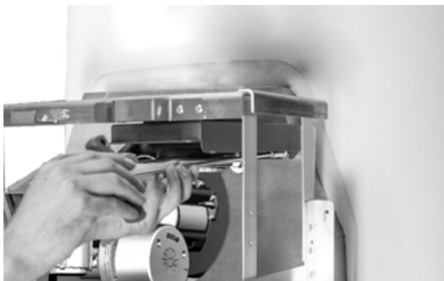
Fig. 38: Serraggio del supporto della tenuta a soffietto
